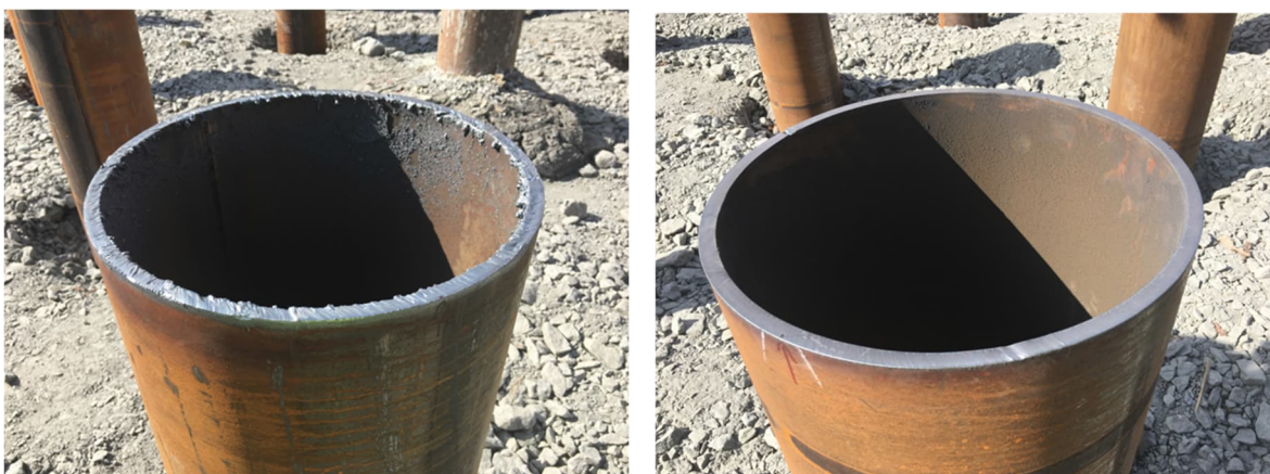
Figur 8.3 Kapning av stålrörspålar med gaskapning (till vänster) och plasmakapning (till höger) med mall.
