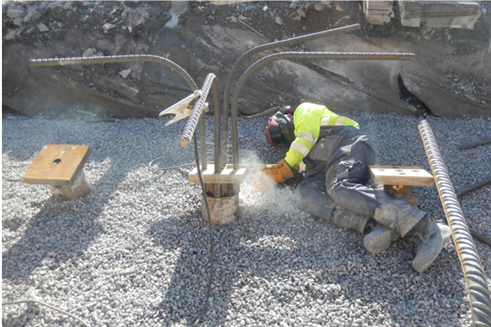
Figur 8.6 Svetsning av topplåt till stålkärnepåle med olämplig arbetsställning.
